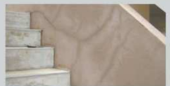
สีเป็นคราบเกลือ (Efflorescence)
