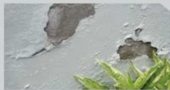
สีลอก่อน (Peeling)
