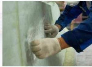
ซ่อมแซมพื้นผิวที่เสียหาย Surface preparation
